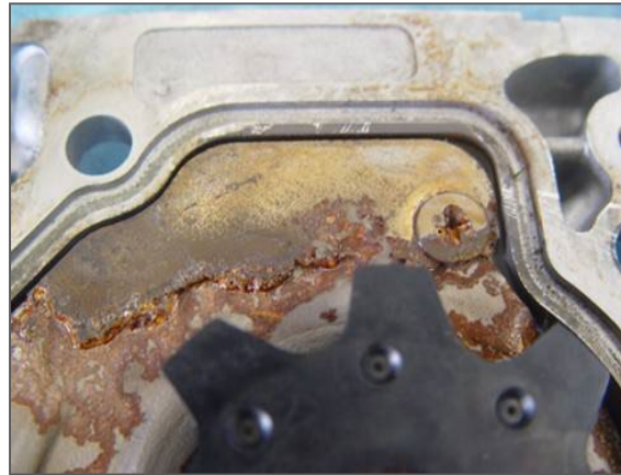
Corrosión de Placa Inferior
